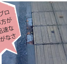
剥がれた点字ブロック
